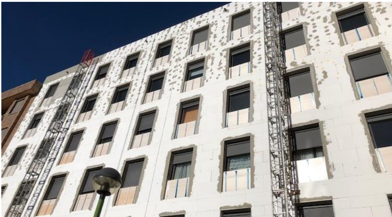
Fachada Posterior: Aplicación del mortero de endurecimiento sobre placas de aislamiento térmico.
