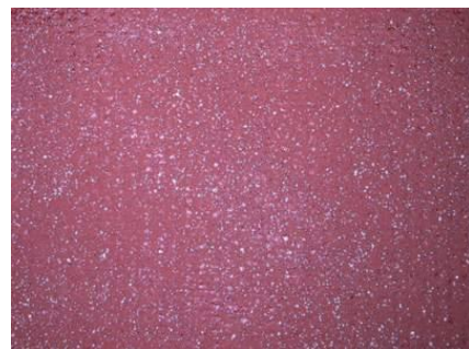
Espolvoreado de arena insuficiente
