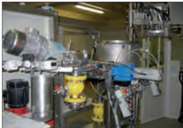
Foto 34.- Detalle del sinfín de extracción
