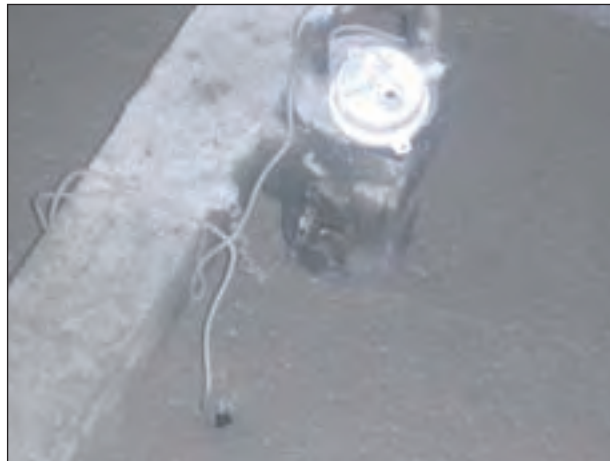
Foto 13. - Sonda de temperatura colocada en el murete de un túnel
