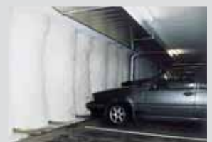
Defectos de diseño
