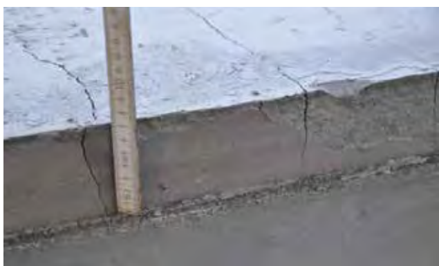
Fisuras producidas por la retracción plástica en un pavimento de hormigón debido a una protección insuficiente de la superficie, antes del secado prematuro
