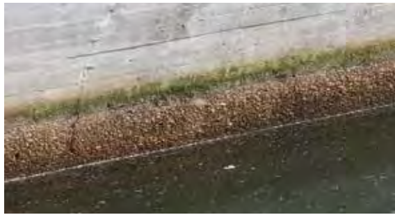
Se puede observar los fuertes lavados y los daños del hormigón en las zonas de los tanques con salpicaduras de agua de las cuencas de tratamiento biológico.
