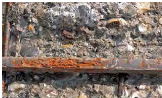
Daños en una estructura de hormigón debido a un recubrimiento insuficiente y a la mala calidad del hormigón
