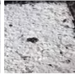
Superficie muy expuesta a la intemperie
