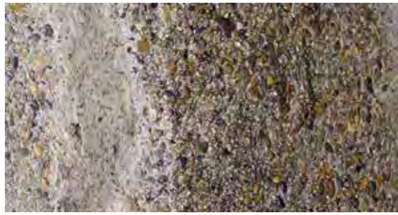
Debido a una exposición continua, la capa de cemento se erosiona en una primera fase, y posteriormente áridos cada vez más grandes se frotan, se golpean y se lavan de la pasta de cemento.
