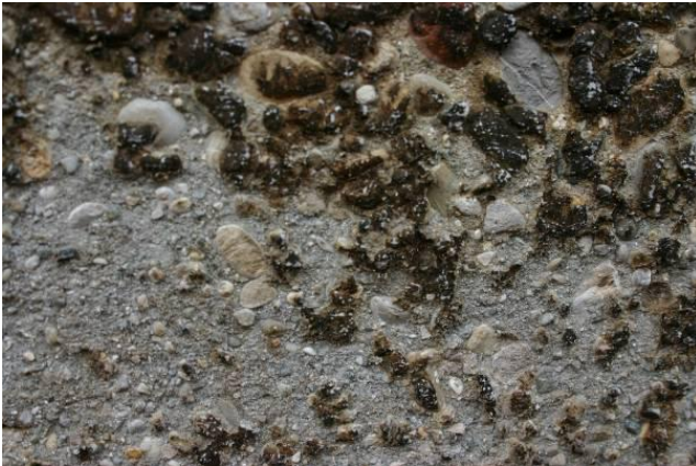
Ilustración 4. Vista ampliada de las zonas de hormigón no tratadas
