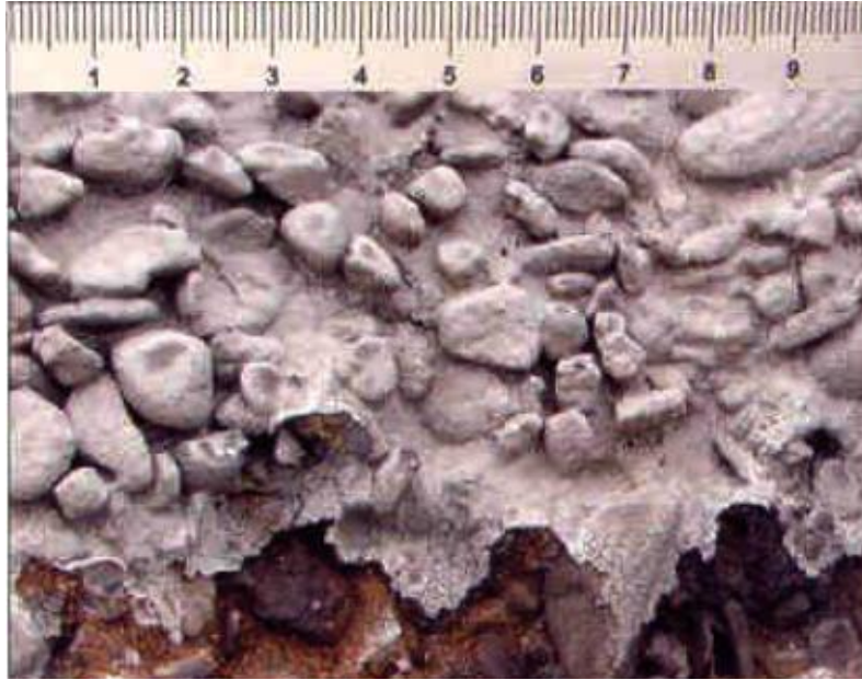
Fig. 8: Capa de revestimiento de protección colocada sobre hormigón no bien preparado
