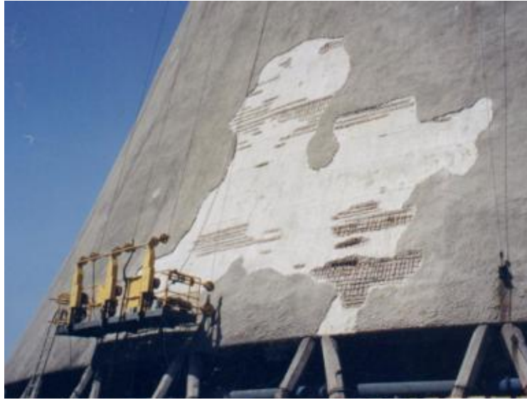
Fig. 6: Inadecuado material de reparación desprendiéndose pocos años después de la reparación.
