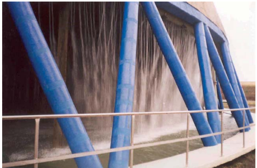
Torre de refrigeración, Polonia.
