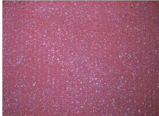
Espolvoreado de arena insuficiente
