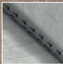
Filtraciones en juntas de construcción
