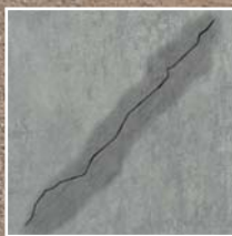
Filtraciones en grietas
