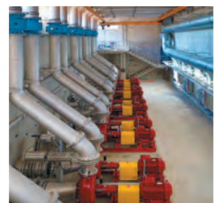
SALAS DE MÁQUINAS
