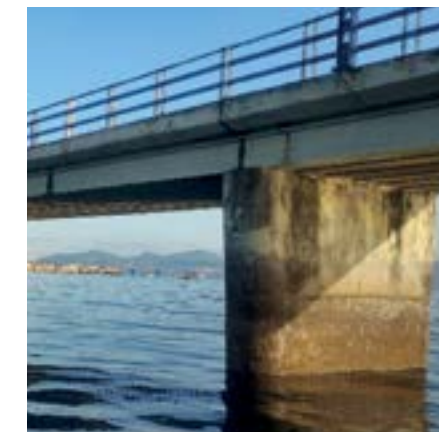
En esta zona las vigas de borde están en perfectas condiciones, salvo la suciedad en forma de «chorretones» producida en la zona de junta, y probablemente en zona de drenajes que no estén correctamente mantenidos.
