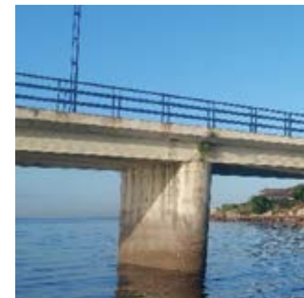
Las vigas de borde en esta zona están en perfectas condiciones. No se aprecia ningún defecto, salvo en las zonas de las juntas, donde hay resto de humedad, debido al mal tratamiento de las mismas.
