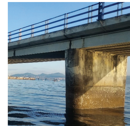
En esta zona las vigas de borde están en perfectas condiciones, salvo la suciedad en forma de «chorretones» producida en la zona de junta, y probablemente en zona de drenajes que no estén correctamente mantenidos.
