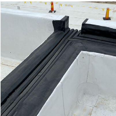
JUNTAS DE DILATACIÓN
