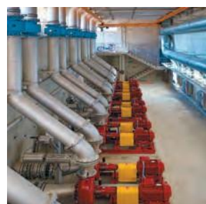
SALAS DE MÁQUINAS
