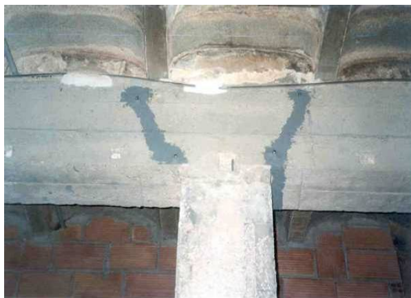
Fig. 5.1. Detalle de las fisuras inyectadas con resina
