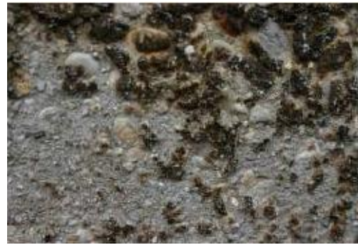
Vista cercana de las zonas de hormigón no tratadas
